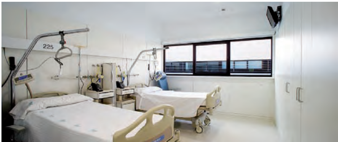
Figura 8. Habitació amb sostre radiant
