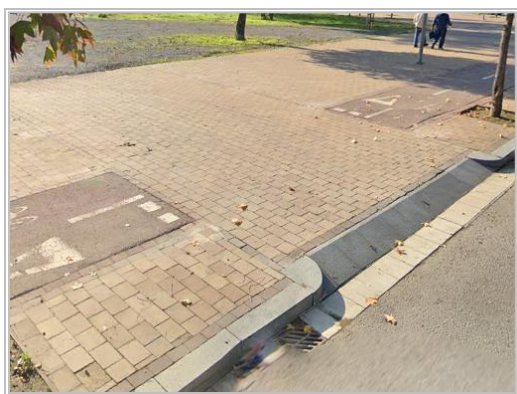
Imatge 18. Interrupció de la senyalització horitzontal en un gual. Font: AIM, elaboració pròpia.
