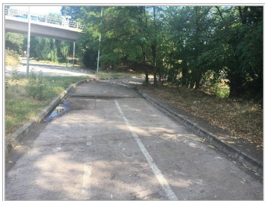
Imatge 5. Carril bici en mal estat i pintura esborrada. Font: AIM, elaboració pròpia.
