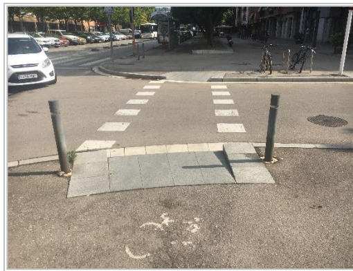
Imatge 13. Connexió entre voreres bici amb senyalització horitzontal esborrada. Font: AIM, elaboració pròpia.
