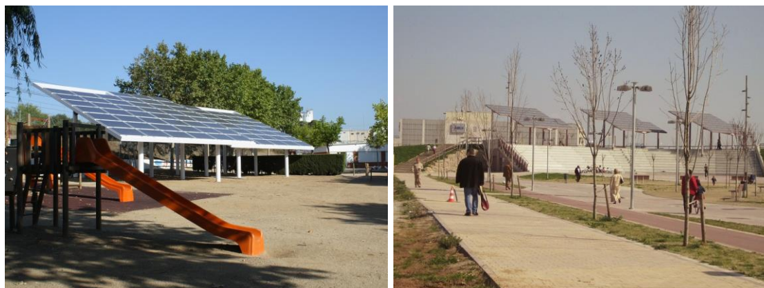
Figura 59- Instal·lacions fotovoltaïques a Mollet del Vallès
