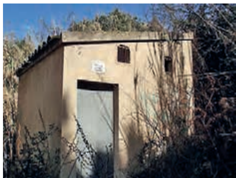
Figura 3. Caseta de cloració. Foto: A. Morera
