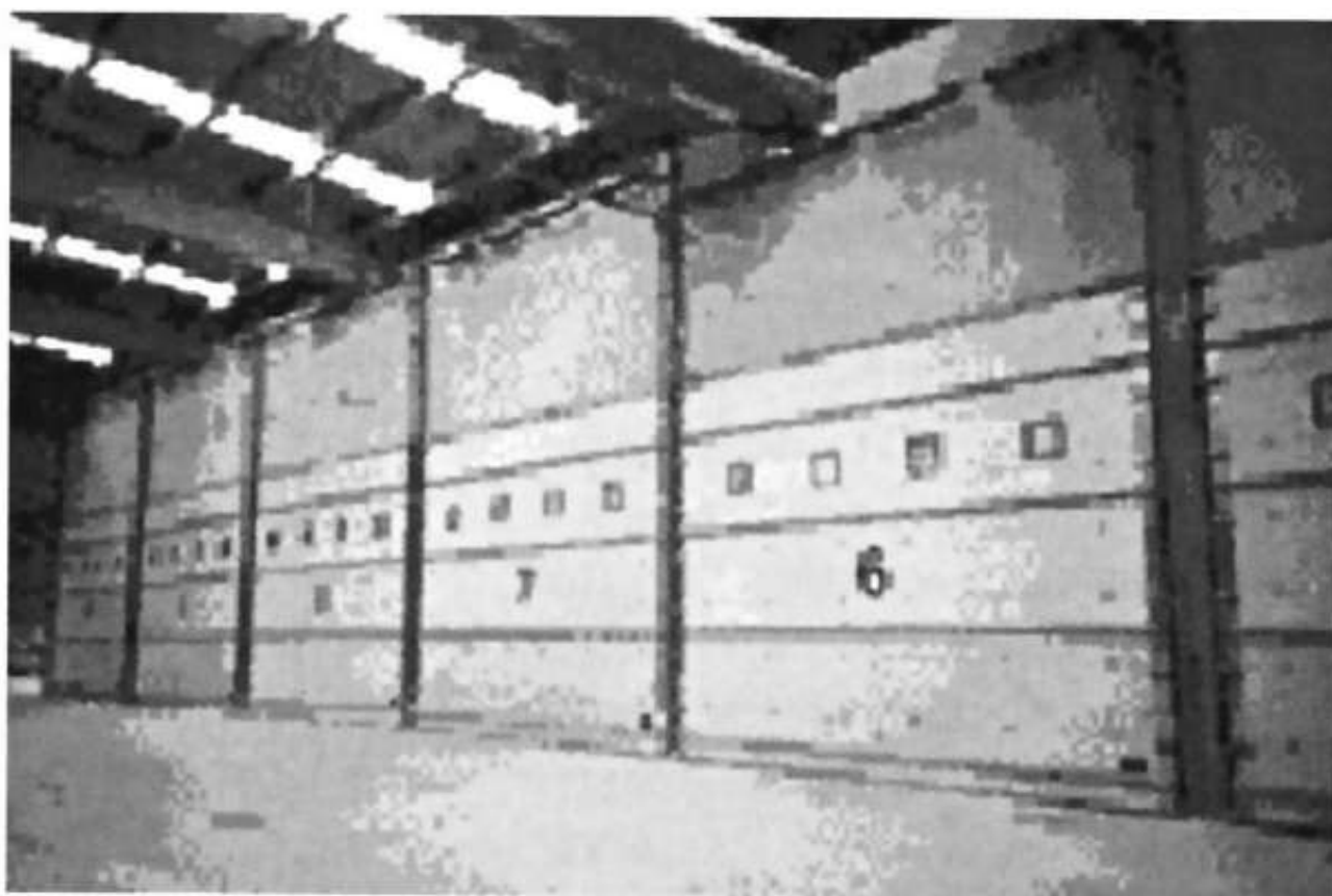
Figura 15. Fotografia dels túnels de la planta de compostatge del Consorci de Residus del Vallès Oriental
